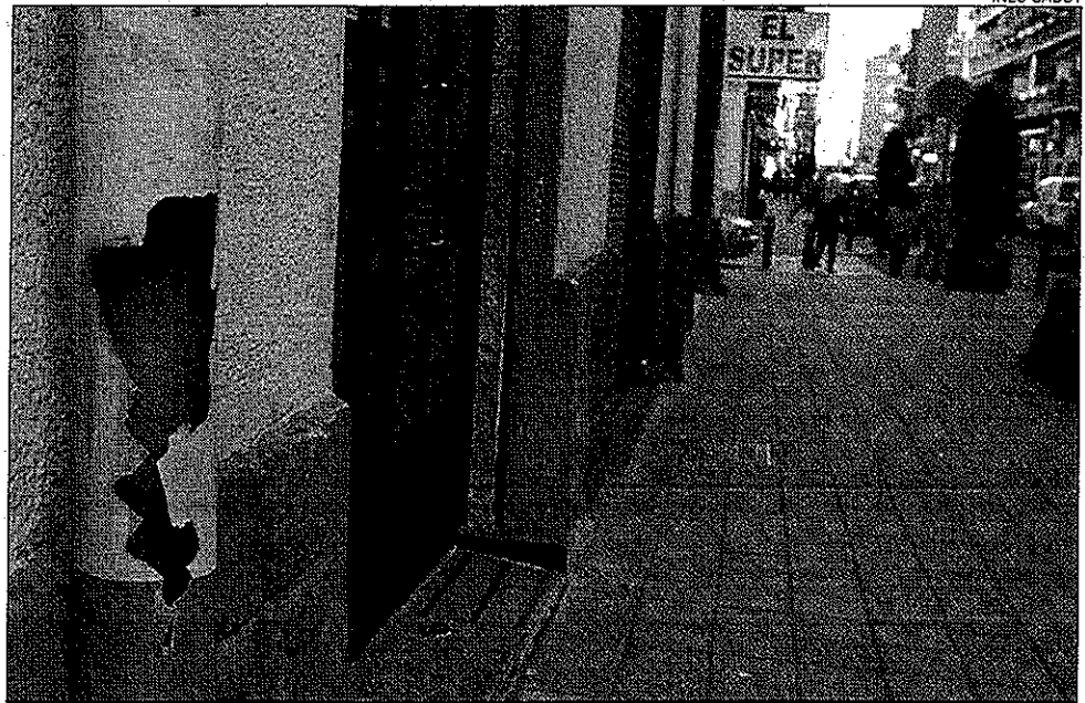
Imagen de la tubería completamente rota en el barrio de Carolinas Altas
